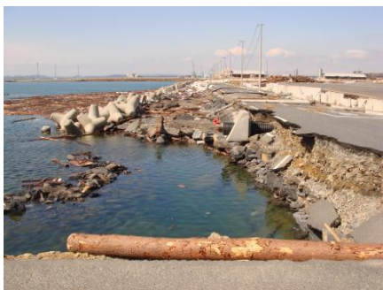
被災した雲雀野海岸堤防
