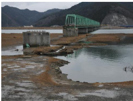
新北上大橋の落橋
